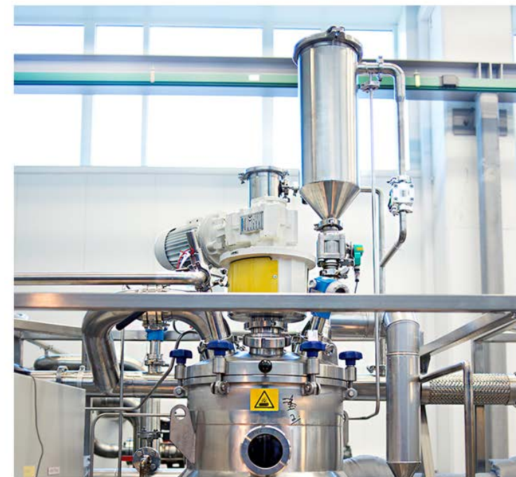
Foto: SINTEFs raffineringsanlegg for marine oljer
